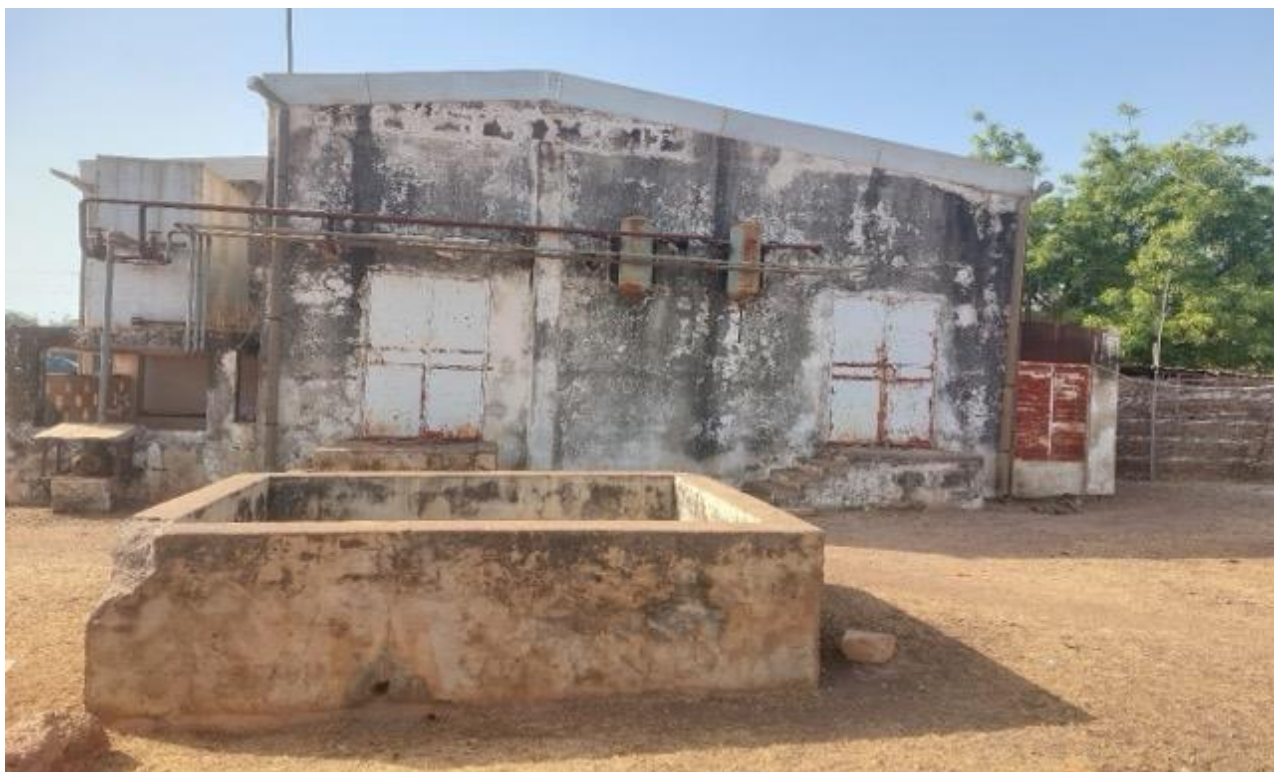
Photo 2: Fabrique de glace de Kédougou dans un état de dégradation avancée
