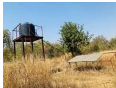
Réservoir d'eau de 1000 litres et 3 panneaux scolaires avec supports métalliques
